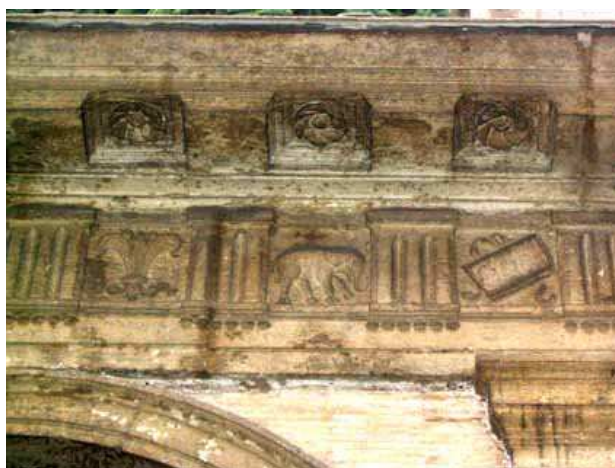
Fig. 5. Roma, palazzo Baldassini, dettaglio del fregio dorico nel cortile (foto F. Mattei)
